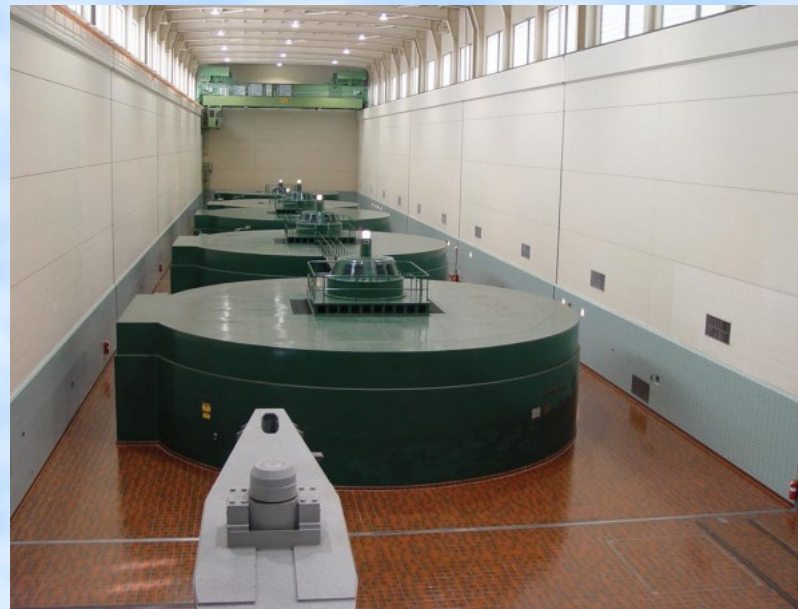
SALLE DES GENERATEURS
